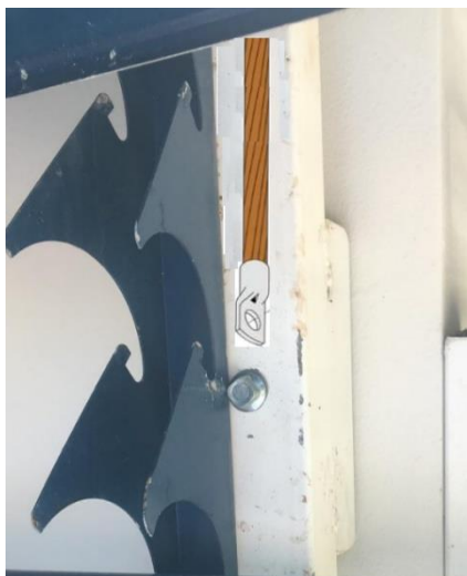
A estrutura dos brizes deverão ter pontos de aterramento
