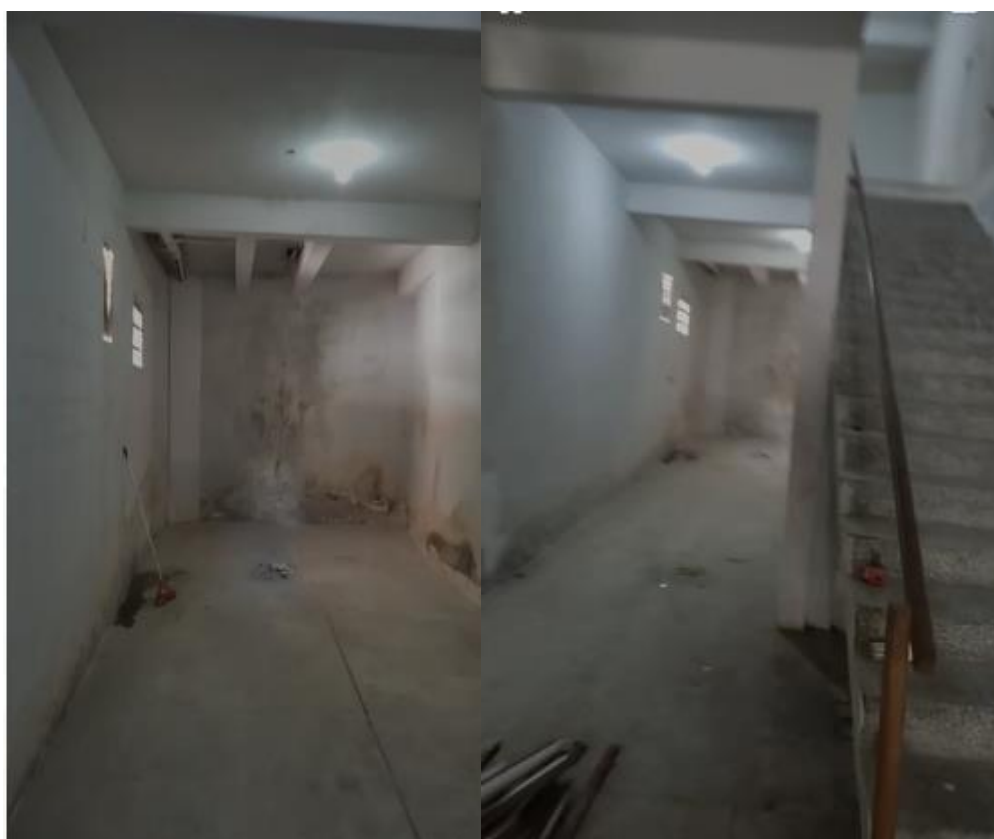
Figuras 02 e 03 – Paredes do fundo com fissuras e bastante úmidas (fica na parte inferior do reservatório).
