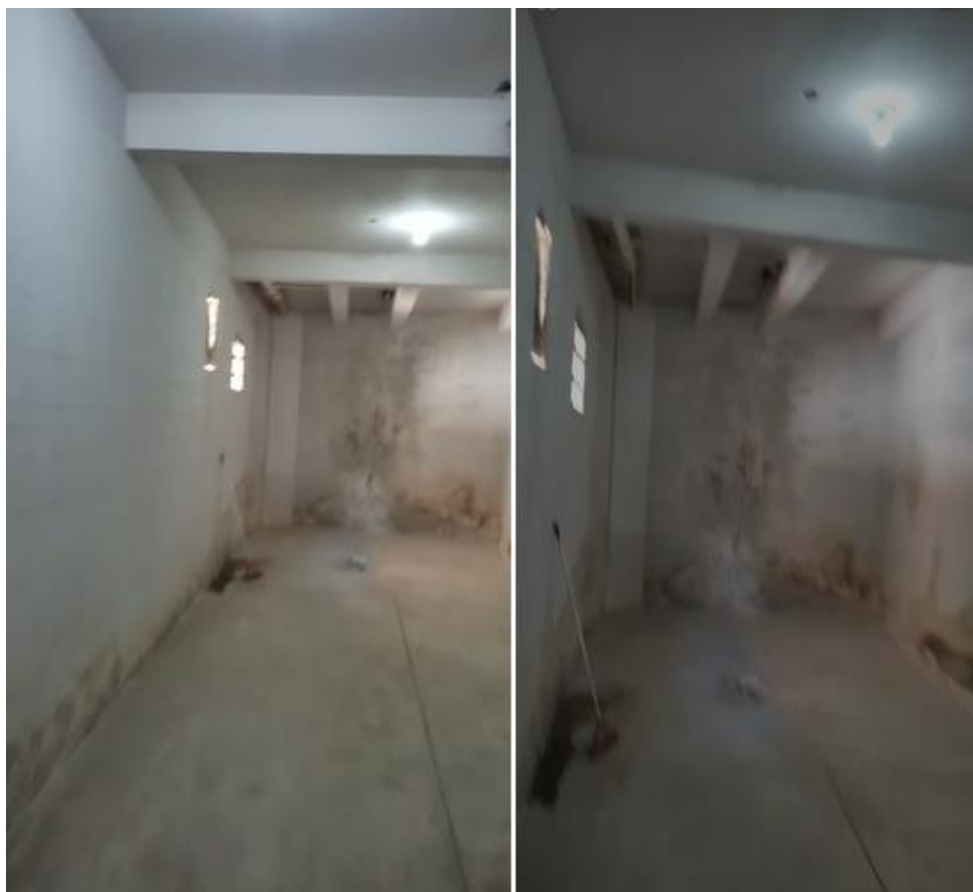
Figuras 04 e 05 – Piso danificado (lado esquerdo), parte inferior das paredes estavam úmidas. Vigas próxima a laje também sofreu com umidade (ferrugem exposta).
